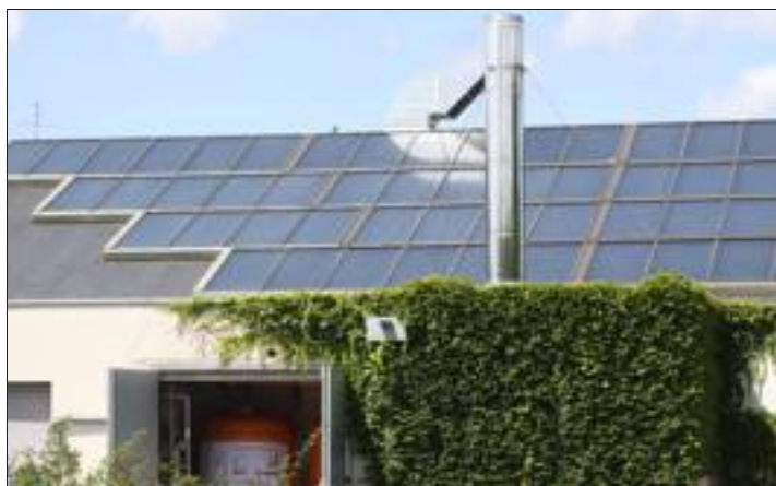
À Mulhouse, les piscines de Bourzwiller (notre photo) et de l'illberg sont équipées de capteurs thermiques pour chauffer l'eau des sanitaires et préchauffer celle des bassins. Archives Dom Poirier
